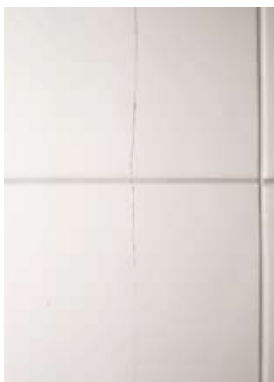
Bilde 3: Flis som har sprukket over en svinnsprekk
