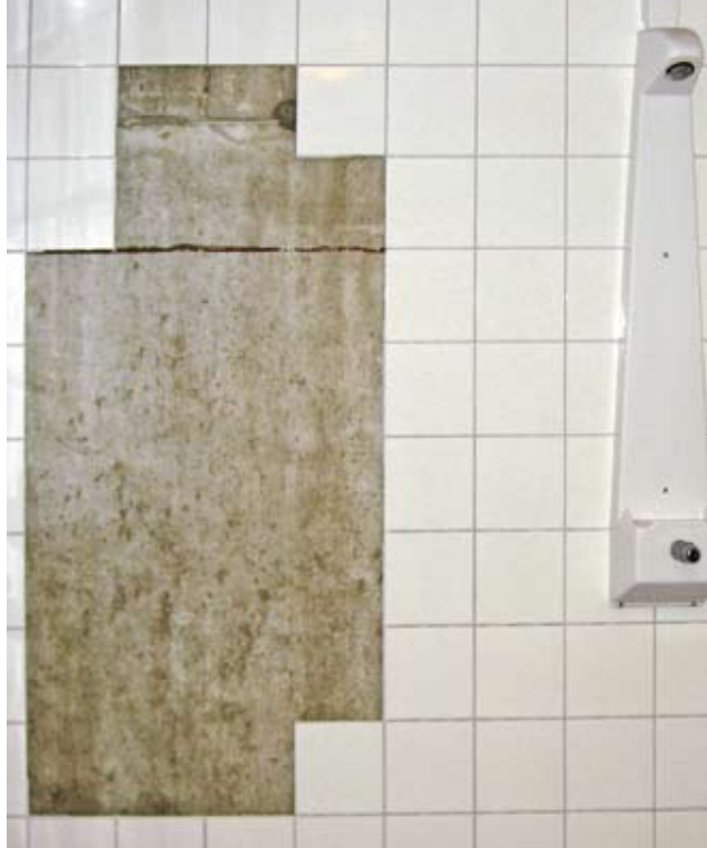
Bilde 1: Flisene i et dusj- og garderobeanlegg begynte plutselig å bue ut
