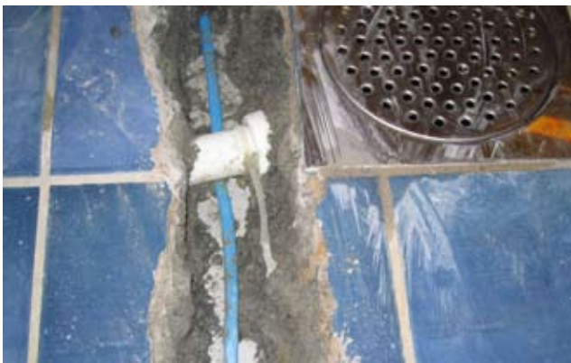
Bilde 1 Kabler som har ligget i hulrom under rør og har fått skade. Unngå direkte kontakt ved mellom kabler og rør!
