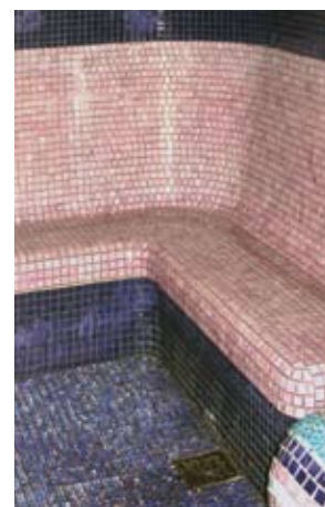
Gulvet har sluk, noe som letter rengjøringen. Dampdysene må plasseres nede ved gulvet og «kamuffleres», slik at den varme dampen ikke kan komme i nærheten av bar hud
