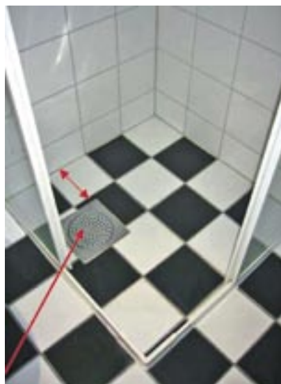
Bilde 8: Ved fornying og utbedring av våtrom er ofte slukplasseringen gitt. Både avrenning og fall må tilpasses lokale forhold.
