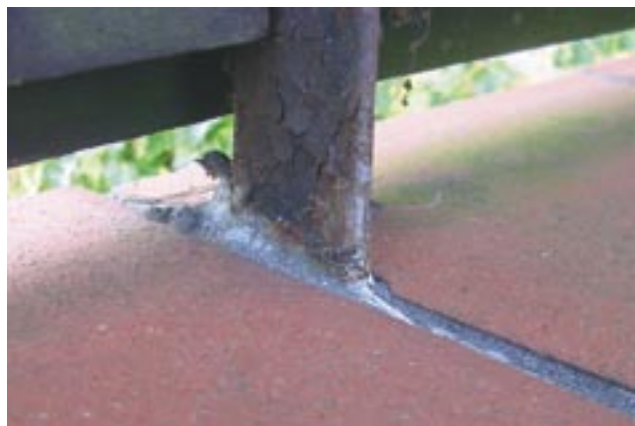
Jern som rustet øker i volum og sprenger i stykker betongen
