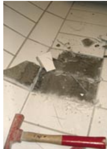
Løse fliser kan være et symptom på at limet har mistet vedheft, men det kan også skyldes bevegelser mellom underlag og flis.
