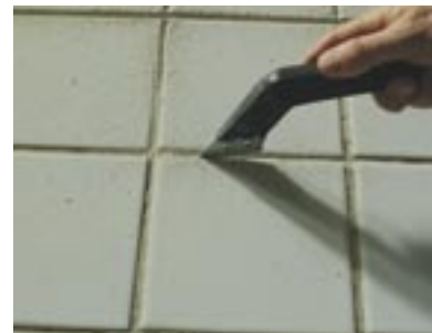
Fugemassen forvitret raskt og kunne utkrasses etter kort tid.
