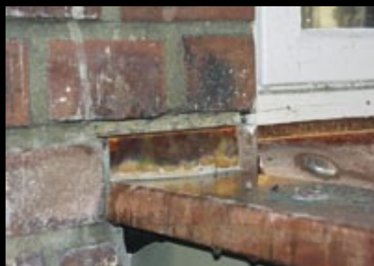
Disse bildene er utlånt av sivilingeniør Erik Algaard, rådg. ingeniør i bygningssysikk og materialteknologi, Muti-consult AS. De inngår i hans skrekkkabinett for dårlig detaljforståelse og håndverksskikk.
