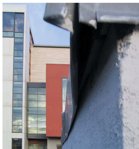
Ikke slik heller! Dette er utført i 2002...
