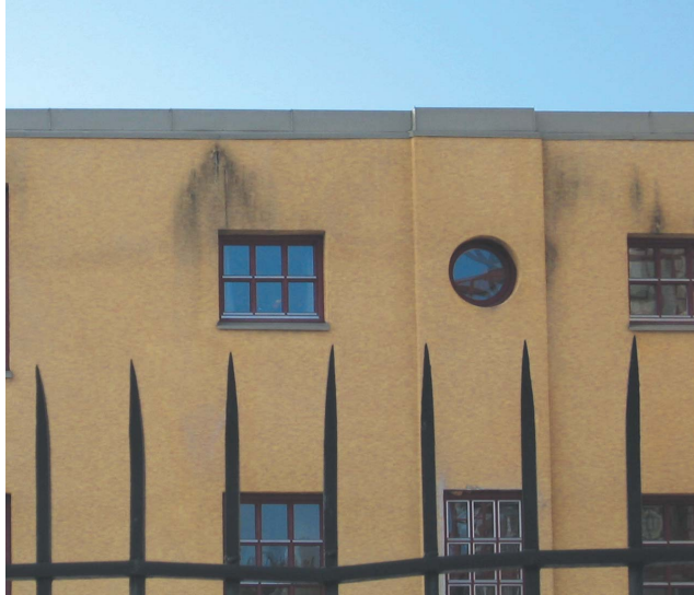
Misfarging på grunn av feilprosjektering og lekkasjer i enkel-falsene
