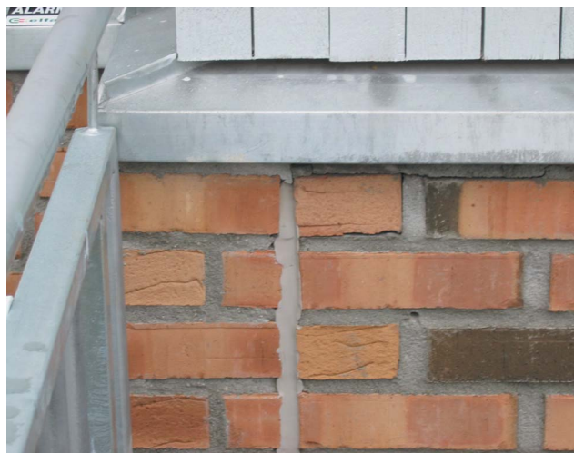
Sprekkdannelse pga. svak overgang
