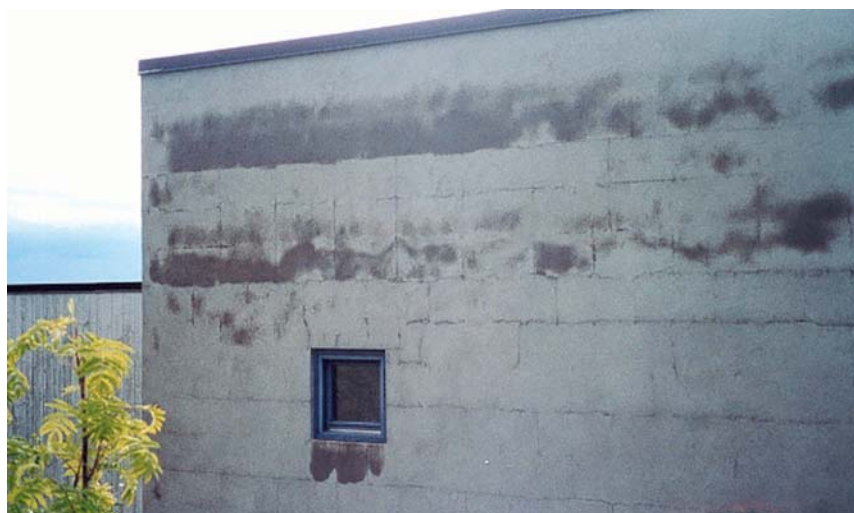
Tynn pussbehandling med mange riss gir dårlig vern ved regnpåkjenning. Foto: Alf M. Waldum
