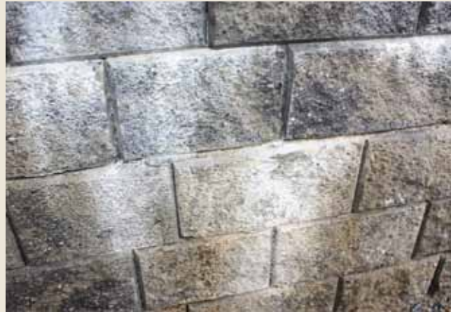
Når fasaden stadig fuktes ned og tørker opp, øker risikoen for at kalk og salter frigjøres og transporteres til overflaten
