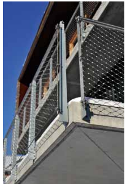
Balkongene er i lys betong med rekkverk av wirenett som er spent mellom stendere av galvanisert stål
