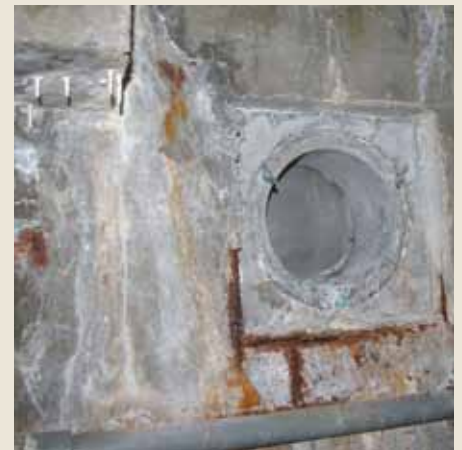
Gamle basseng har sjelden membran eller vannrett betong, noe som resulterer i fuktvandring i konstruksjonene og inn i tilstøtende rom
