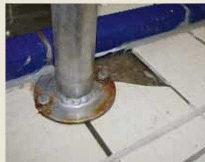
Utvasking av fuger resulterer i at fliser sprekker og løsner
