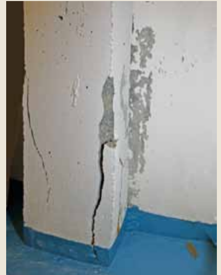
Sprekker og skader i bærende konstruksjoner
