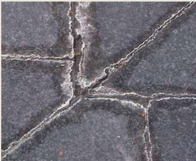
Figur1: Langs fugene i skifergulvet er det fuktrender – og et belegg som vanskelig lar seg vaske bort
