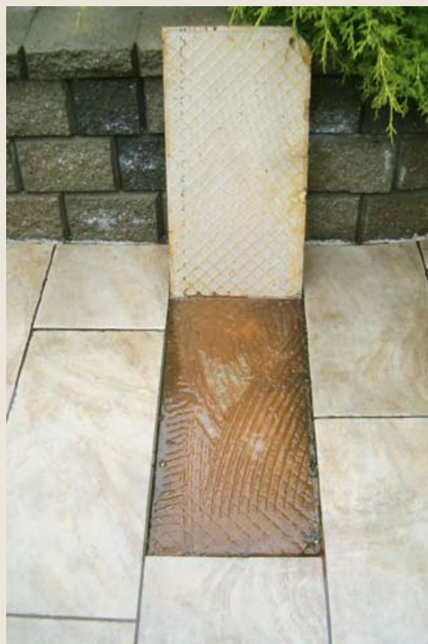
Figur 4: Mangelfull limdekning resulterer både i løse fliser og utfelling
