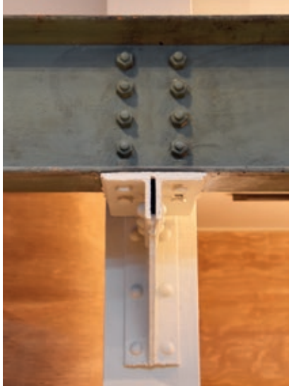
Traverskranskinne. Foto: KIMA
