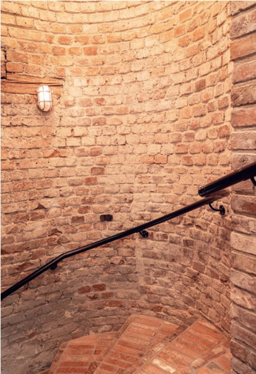
En ny trapp er etablert fra 1. etasje og ned til underetasjen. De originale veggene er filset, og trappetrinn er kledd med ombrukstegl fra Høine. Foto KS
