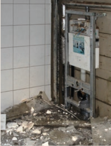
Figur 2: Den fuktømfintlige gipsplateveggen til høyre hadde ikke tålt påkjenningen og måtte rives
