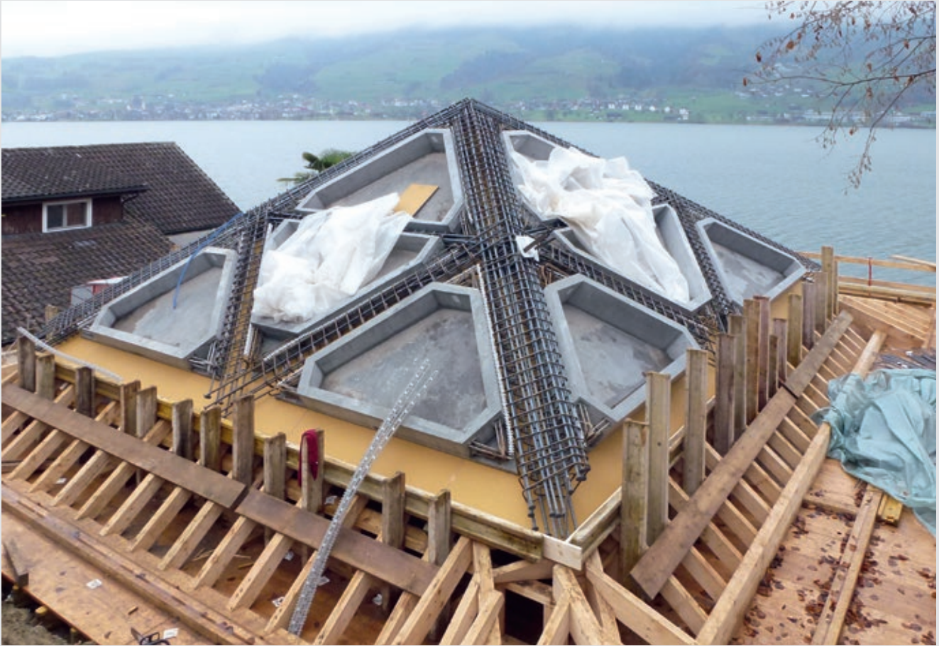
Betongtaket er avstivet med stålwire og hviler på to frittstående Y-formede betongpillarer. Takkonstruksjonen er en kombinasjon av plasstøpt betong og prefabrikkerte betongelementer
