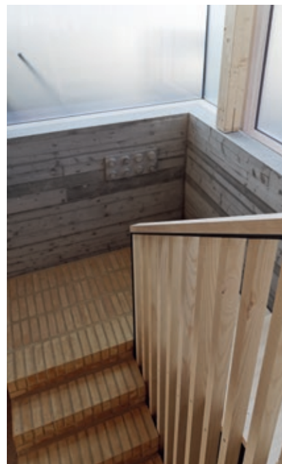
I bakkant, mot terreng, ble det nye trapperommet en lyskilde for underetasjen
