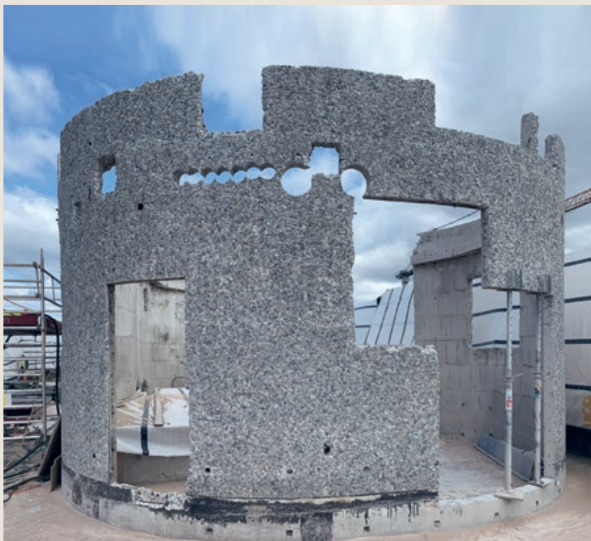
Konstruksjonen hadde mange sår og utsparinger fra om- og påbyggingen i 1989. Men det viste seg heldigvis at naturbetongen var i veldig god stand etter 65 år
