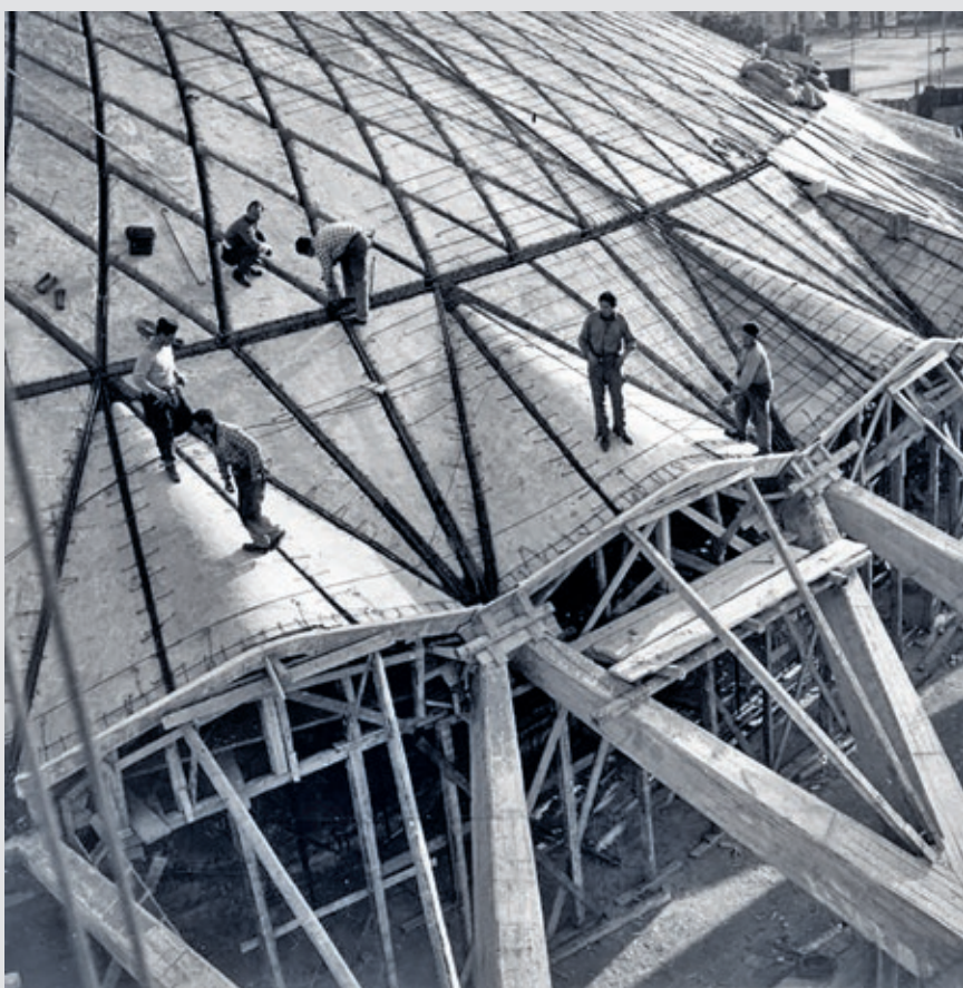
Palazzetto dello Sport under bygging. Arenaens tak er et kuppelhvelv i betong med støpte ribber. Skallet er 61 meter i diameter, konstruert av 1620 prefabrikkerte betongelementer og med skrånstevre i betong. Mye av konstruksjonen var prefabrikkert, og hele kuppelhvelvingen ble bygget på førti dager. Kilde: Ministero dei beni e delle attività culturali e del turismo/wikimedia
