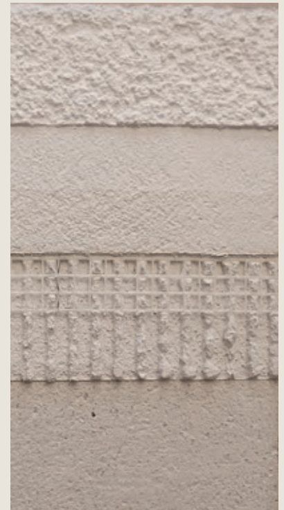
Når det isolerende laget er tørt blir glassfibernetting pusset inn. Deretter er det klart for slutt puss og ev. maling
