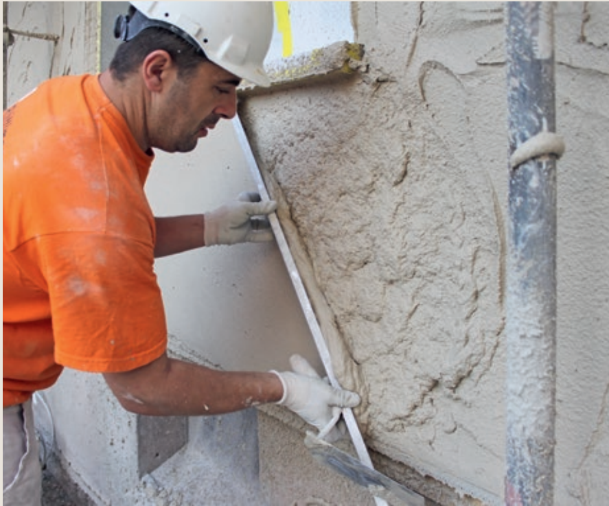
Det isolerende laget påføres med sprøyte og glattes ut. Det er lett å bearbeide
