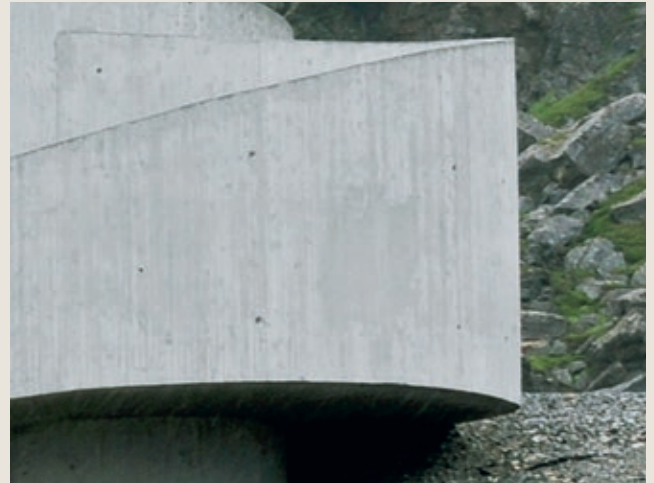
Mindre synlig reparasjon: Mørtel med tilsv. fargenyansanse og struktur som øvrig betongflate
