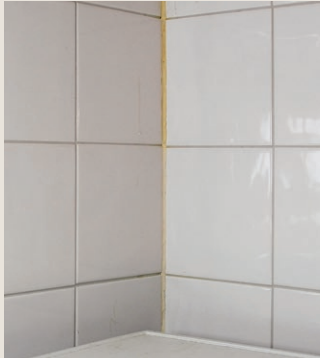
Figur 3: Gulnede elastiske fuger er ulekkert og kan lett mistolkes som dårlig renhold. Når misfargingen først har oppstått, lar den seg ikke fjerne
