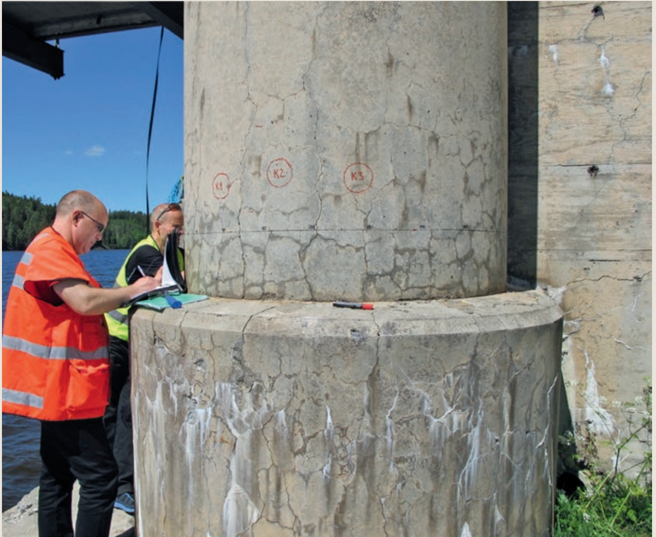
Inspeksjon av bru med skader fra alkalireaksjoner. Bård Pedersen, Statens vegvesen (til venstre) og Jan Lindgård, SINTEF Byggforsk i aksjon med måling av rissvidder. Foto: Eva Rodum, Statens vegvesen.
