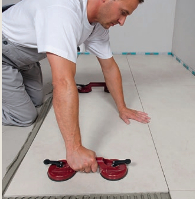
Figur 2: Storformatfliser kan ha mindre partier uten full limkontakt og likevel sitte fast godt fast i underlaget
