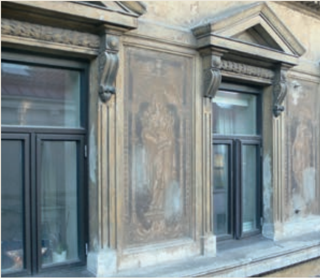
Tilstand før restaurering: Sgraffito-felt i 4. etasje
