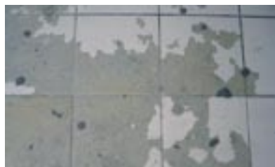
Figur 1: Flisflate hvor glasuren er sprengt av pga. for dårlig frostmotstand. Denne flaten ble også saltet for isfjerning, noe som øker frostpåkjenningen.
