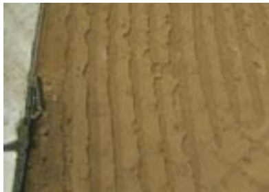
Figur 2: Manglende limdekning: flisene har løsnet grunnet mange åpne riller i limet. Vannansamlinger i underlaget har sprengt løs flisen.
