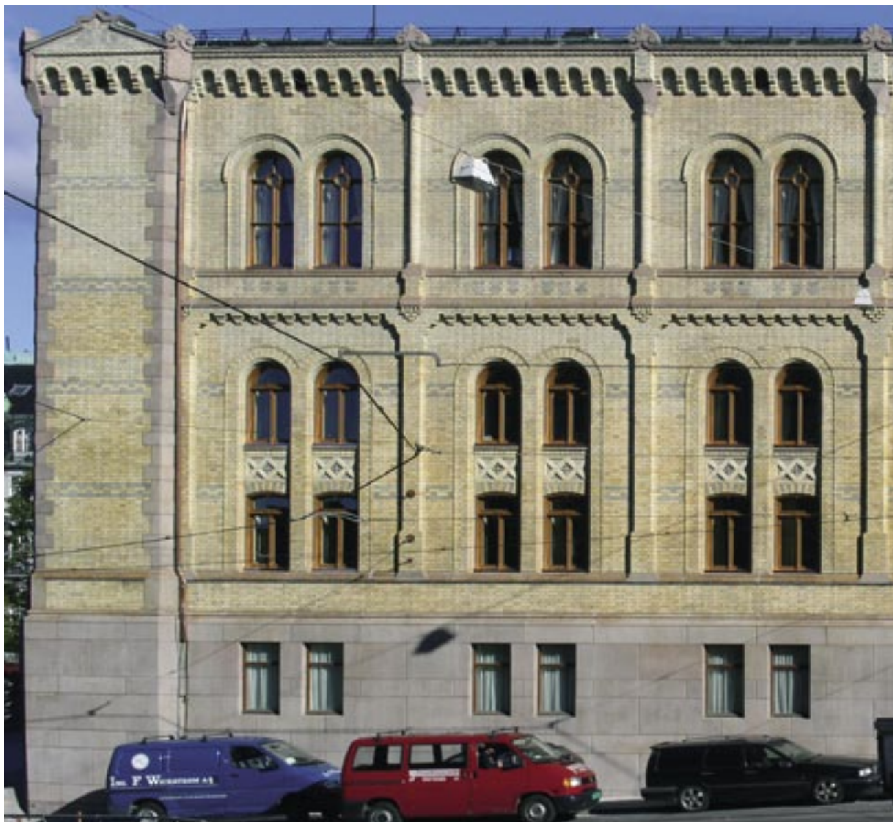
fig. 13 Vestre del av fasaden da stillaset var tatt ned. Her er fasaden ennå fuktig av kalkvanns- behandlingen
