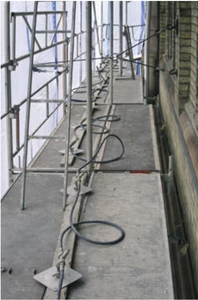
fig. 6 Slangene med vanddyser er lagt ut på stillaset. En vertikal streng med vannslange og magnetdyser styres av dataanlegget slik at overflaten dusjes med styrte intervaller og vannmengde. Her vann i ca 30 sek. pr. 4 min.
