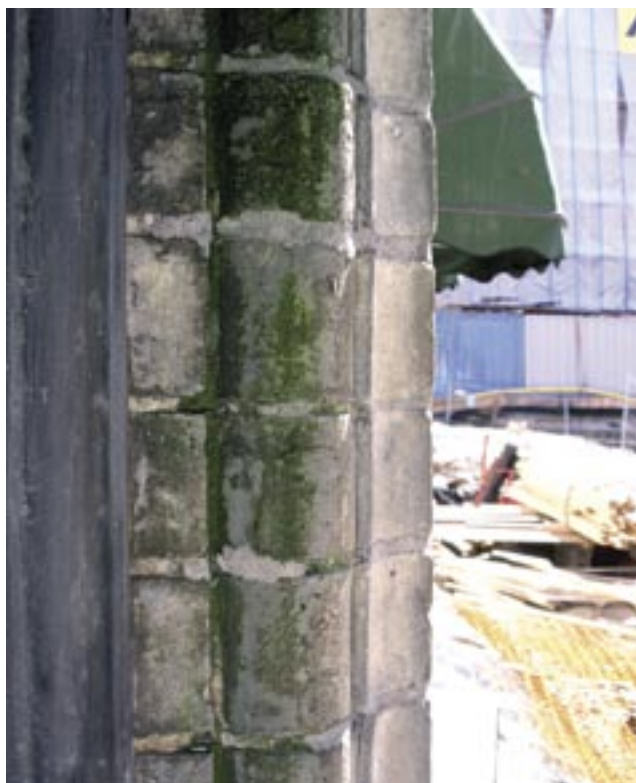
fig. 1 Vindussmyg i annen etasje. Som man ser er det mye grønt der det ikke burde være det. Karmtreet viser også stort behov for nymaling
