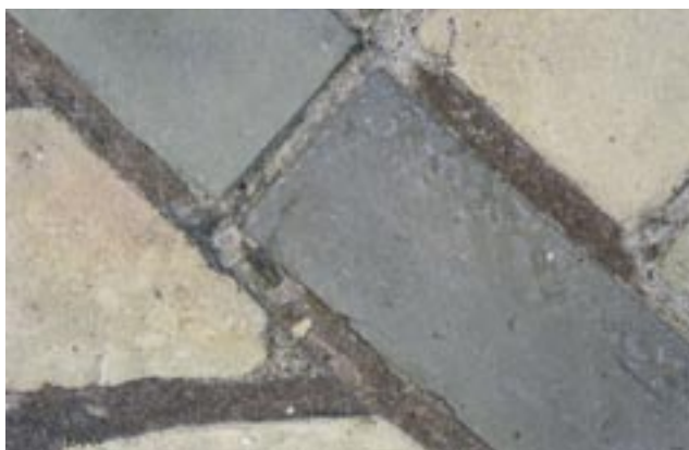
fig. 4 Den rensede overflates ytterste fugemørtel er kun ca 2 mm tykk
