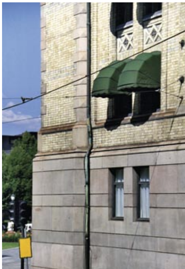
fig. 5 Før rensing: Rust fra trikkeskinner, eksos, bilgummi osv. har satt sitt preg på fasaden
