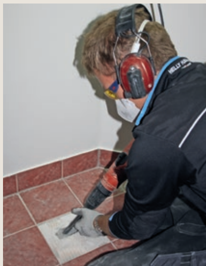
Figur 1: Membraner på våtromsgulv lar seg skjøte med egnete materialer. Arbeidet må utføres av erfarne håndverkere
