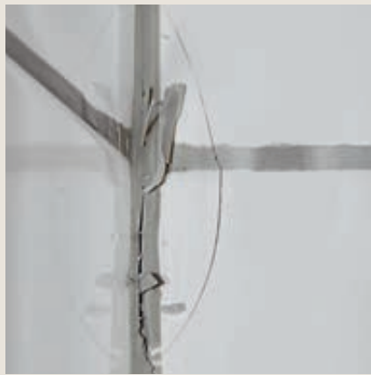
Figur 6: Flisen knakk grunnet manglende klaring mellom de møtende flisene i hjørnet. Silikonen lå kun oppå flisen, grunnet manglende plass spalten
