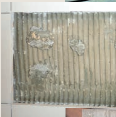
Figur 3: Punktliming medfører store områder med manglende vedheft og hulrom med for mye fukt bak flisene
