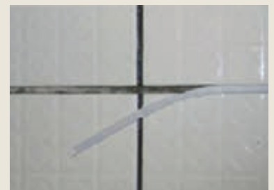
Figur 7: Elastisk fugemasse kun i flissjiktet har lett for å løsne i klorholdige omgivelser
