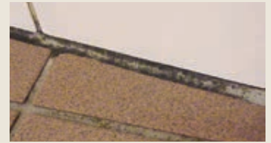
Figur 3: Typisk fuge med fargeendring grunnet mikroorganismer. Her må fugemassen skiftes ut
