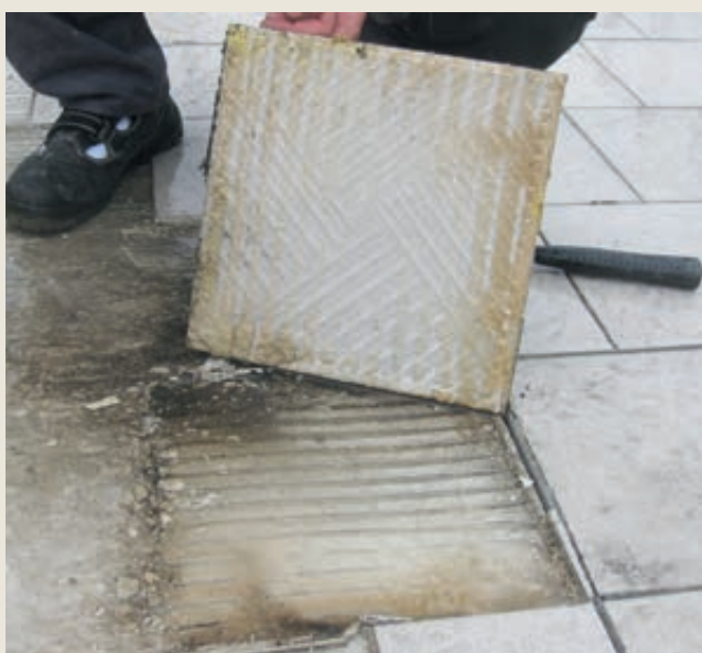
Figur 1: Rillemønster i limet avslører mangelfull limdekning. Flisen har ikke vært baksmurt, ei heller grundig arbeidet ned i limet. Der er kun stedvis limrester på baksiden.
